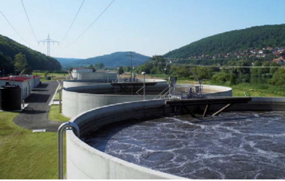
Yeni arıtma tesisi Temmuz ayında işletmeye alındı
